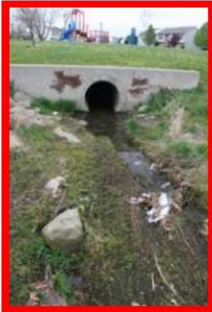
Figure 9a: 36" inflow pipe
